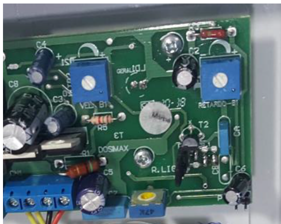
Figura 2: Placa de controle da bomba
